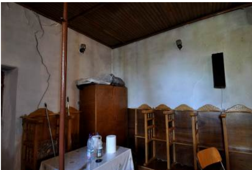
Εικ. 8 Ρηγματώσεις στην εσωτερική βορειοδυτική γωνία.
