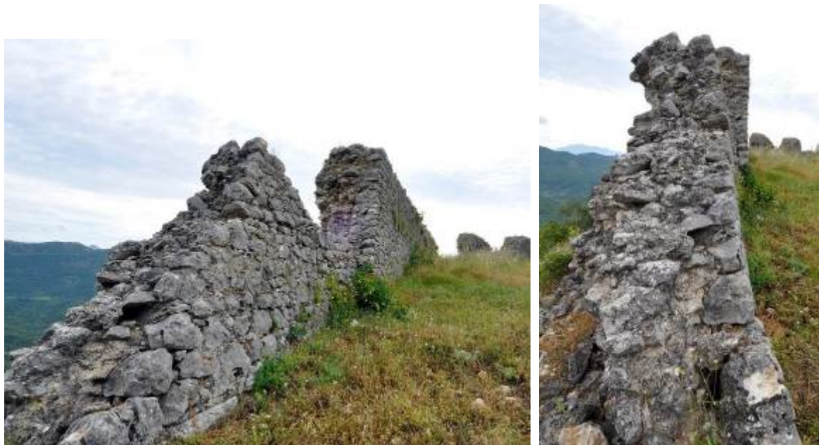
Εικ. 17α&β Ανατολικό άκρο βόρειας (Β) πλευράς με έντονη παθολογία: ανατροπή τμήματος, αποκόλληση, απόκλιση από την κατακόρυφο και ρηγματώσεις.
