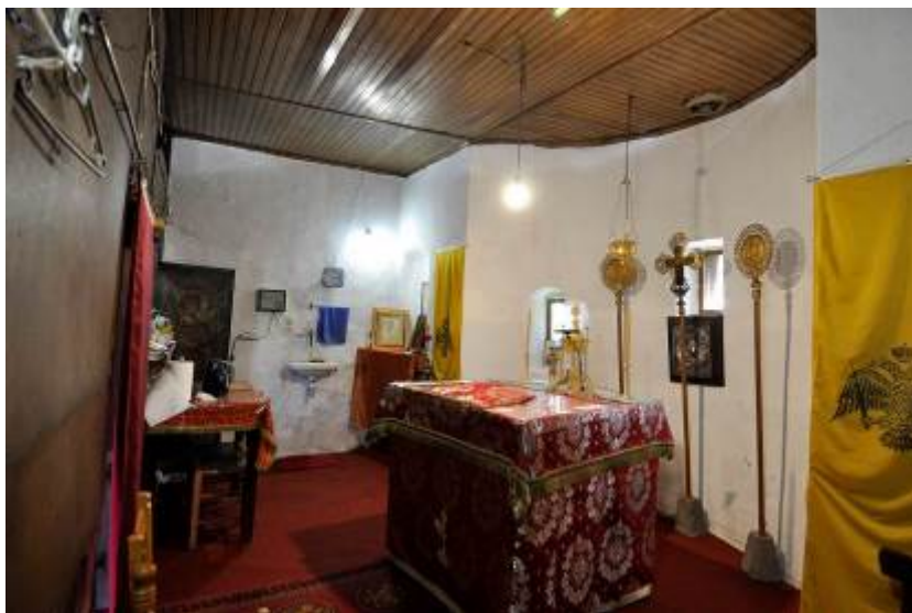
Εικ. 10 Ρηγματώσεις στον χώρο του ιερού.
