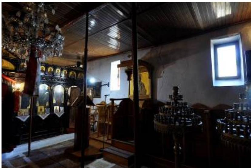
Εικ. 9 Ρηγματώσεις στην εσωτερική νότια πλευρά.
